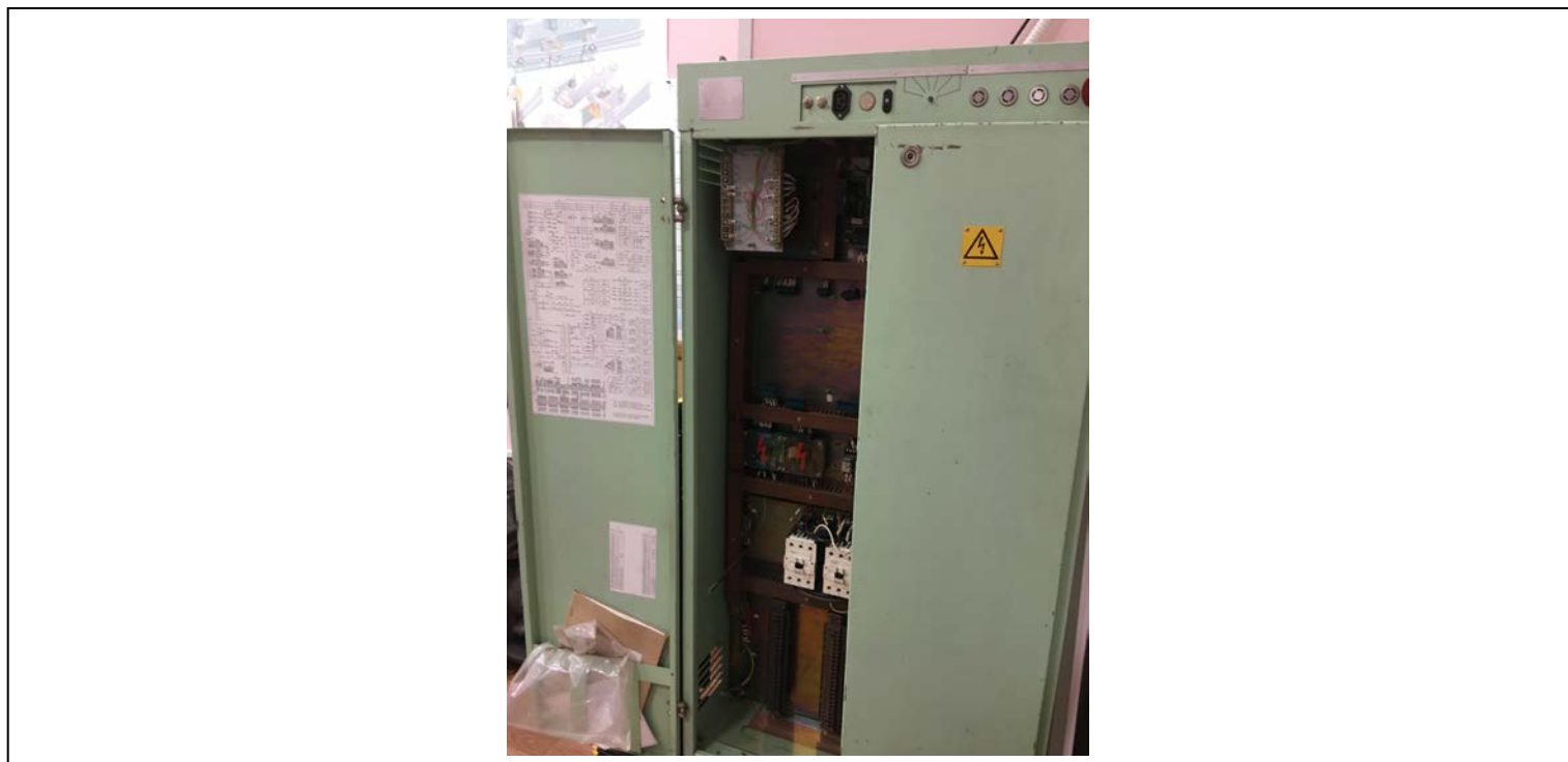
Панель управления пассажирского лифта
